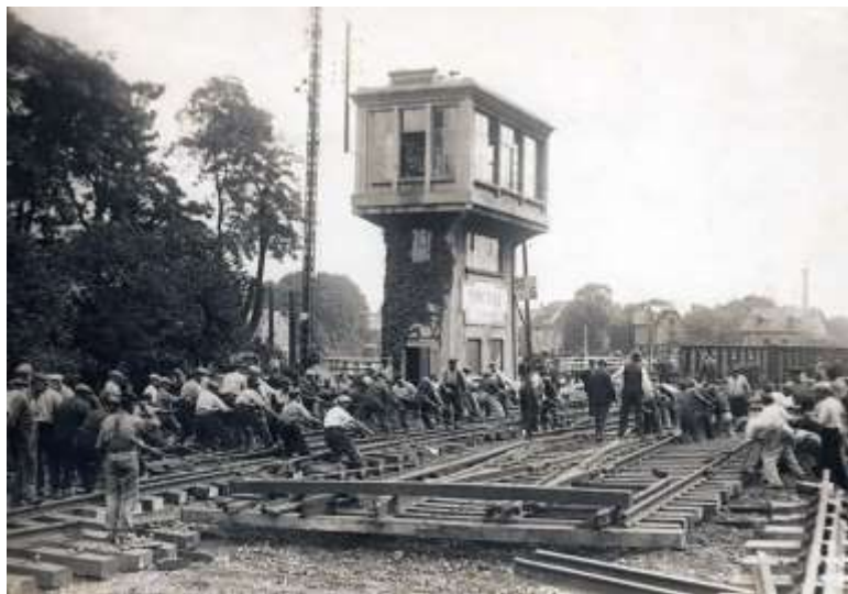
Pontoise : travaux devant le poste d'aiguillage lors du changement des aiguilles et appareils de voies
